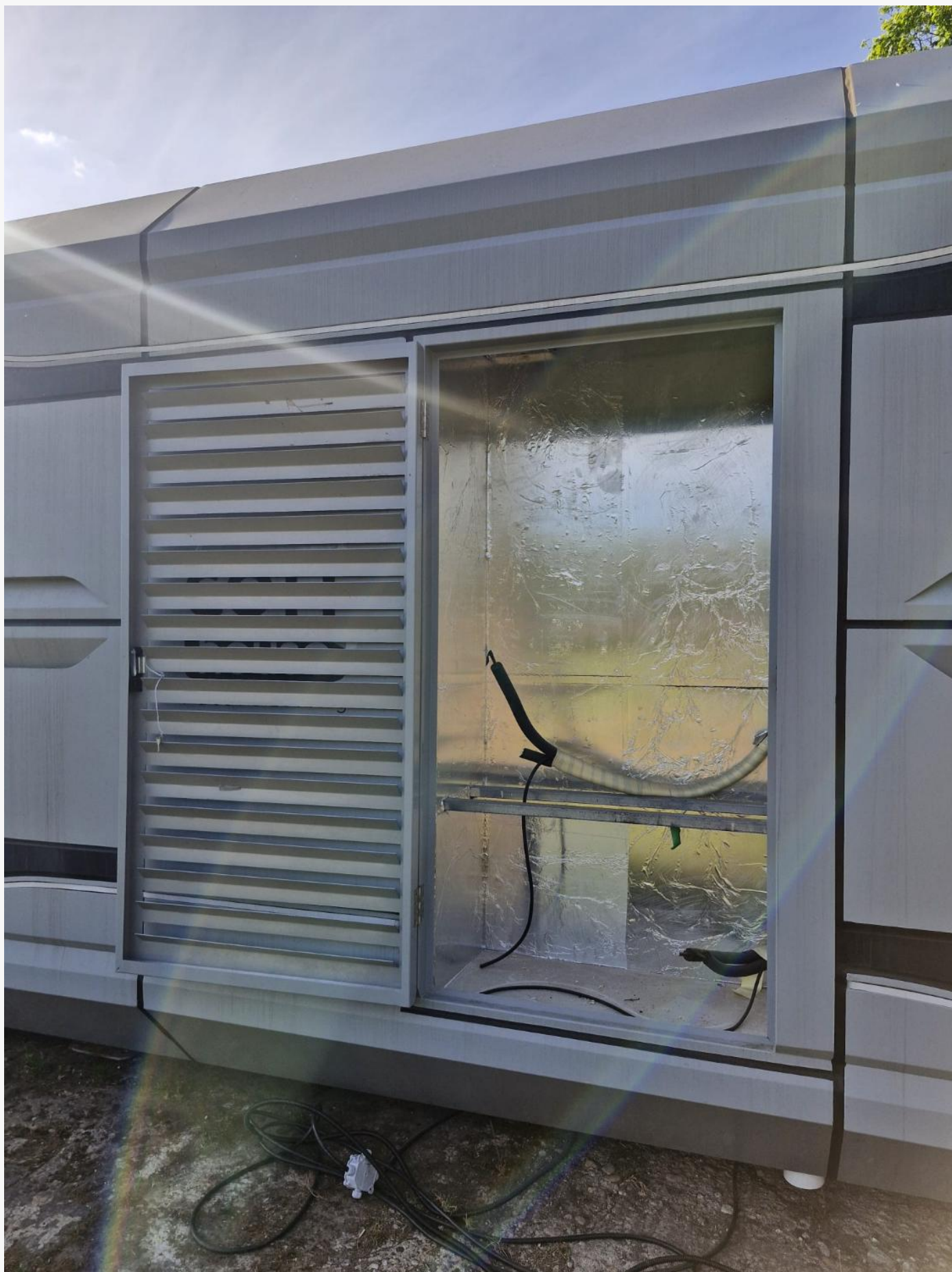
Příprava na klimatizaci
